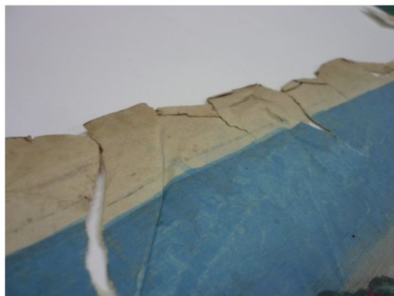
VOP 61 RES : Détail de dégradations.
